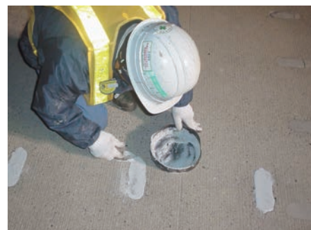
▲ホーンジョイントの跡埋め材として、コールミックスグレーを使用
